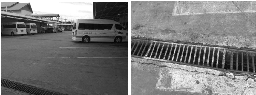
ภาพที่ ๑๐ ตะแกรงปิดท่อระบายน้ำเป็นอุปสรรคสำหรับคนนั่งรถเข็น หรือคนตาบอดได้ บริเวณพื้นที่เชื่อมต่อไปอาคารหลัก เพื่อซื้อตั๋ว และต่อรถ บ.ช.ส
